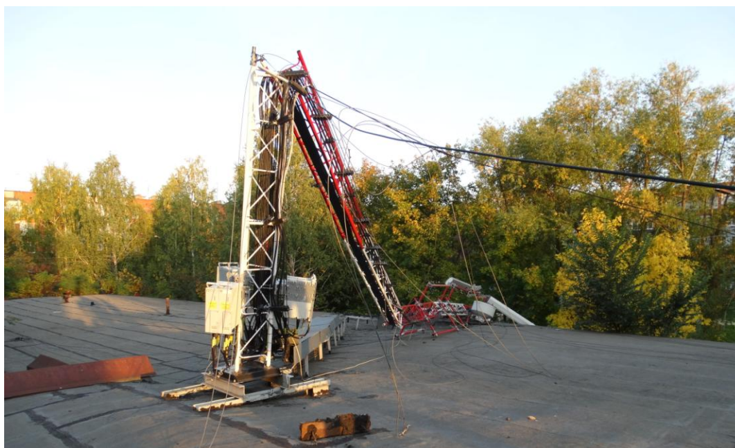
Рис.3 Мачта сотовой связи после обрушения
