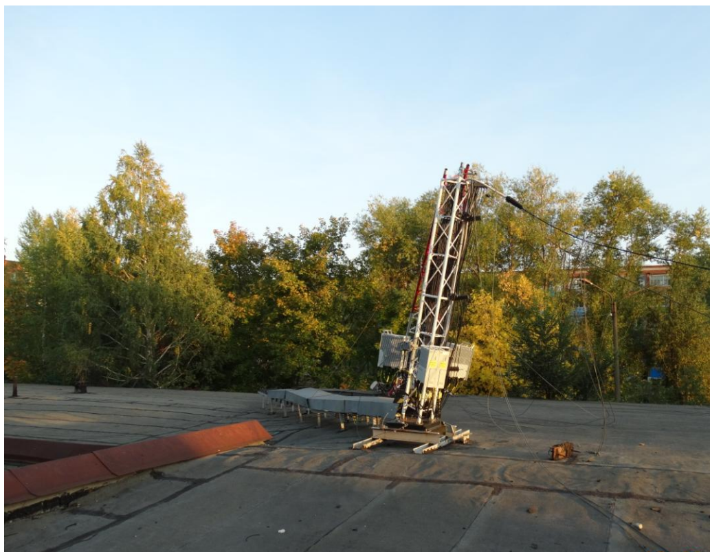
Рис.4 Мачта сотовой связи после обрушения
