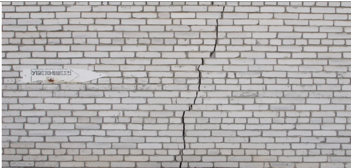
Рис.1 Вертикальная трещина (с шириной раскрытия более 5 мм)
