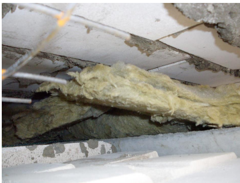
Рис. 3. Разрушение утеплителя в зданиях старой застройки
