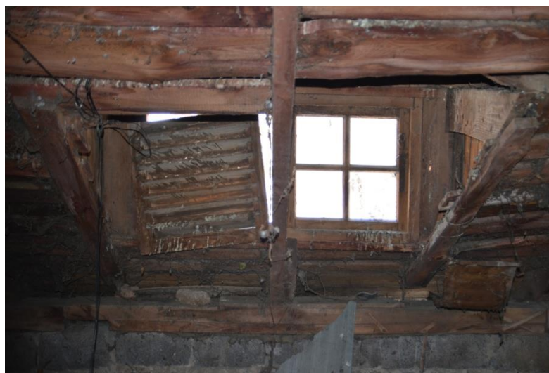
Рис. 1. Состояние слуховых окон в зданиях старой застройки
