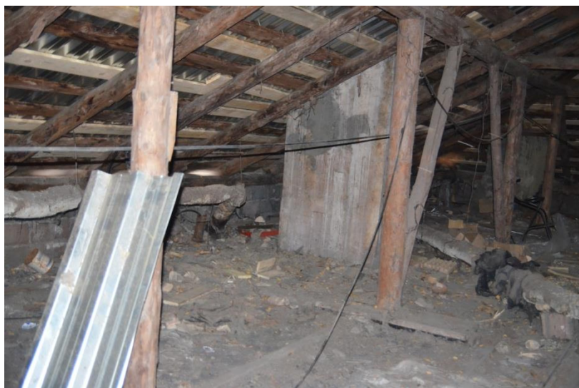
Рис. 2. Состояние чердачного перекрытия в зданиях старой застройки
