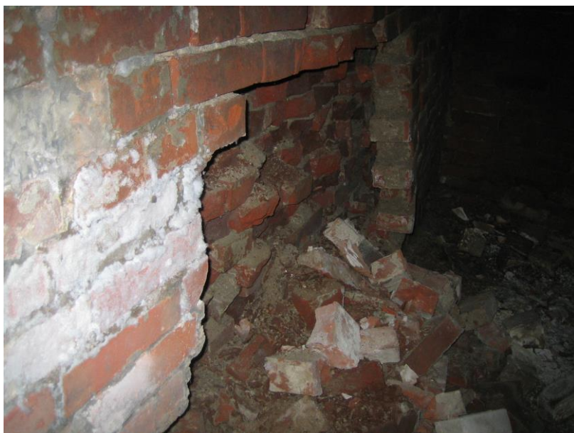
Рис. 5. Вывал наружной стены подвала с внутренней стороны из-за выпучивания в результате бокового давления грунта (степень 3 солевой коррозии – потеря устойчивости и обрушение)
