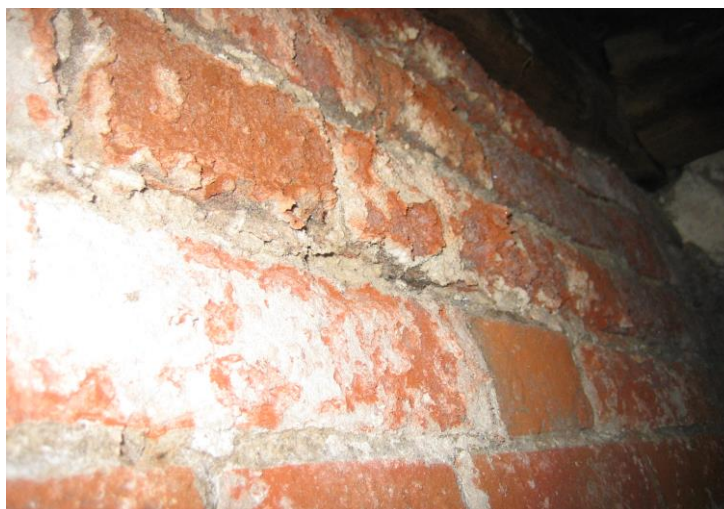
Рис. 1. Признаки солевой формы физической коррозии: высолы, чешуйки, лещадки кирпича, осыпающиеся при прикосновении (степень 1 солевой коррозии)
