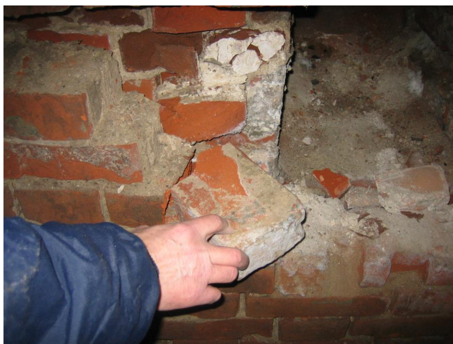
Рис.4. Засолённая кладка утратила прочность и любой из кирпичей легко изымается
