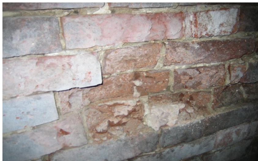
Рис. 2. На кирпичной кладке высолы и повреждения кирпичей в виде каверн на всю площадь ложка и тычка (степень 2 солевой коррозии)
