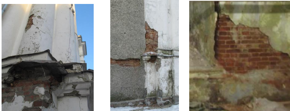
Рис. 2. Фото-фиксация некоторых дефектов кирпичных стен храма:
