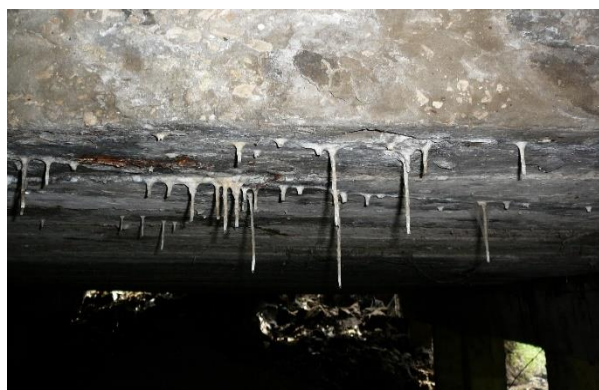
Рис. 2. Выщелачивание бетона с образованием сталактитов
