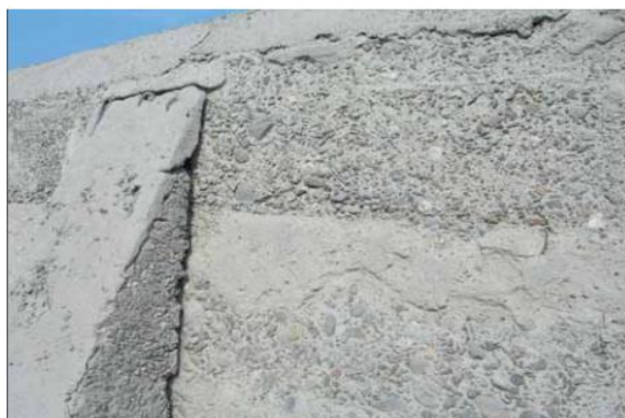
Рис. 1. Выщелачивание на поверхности бетона
