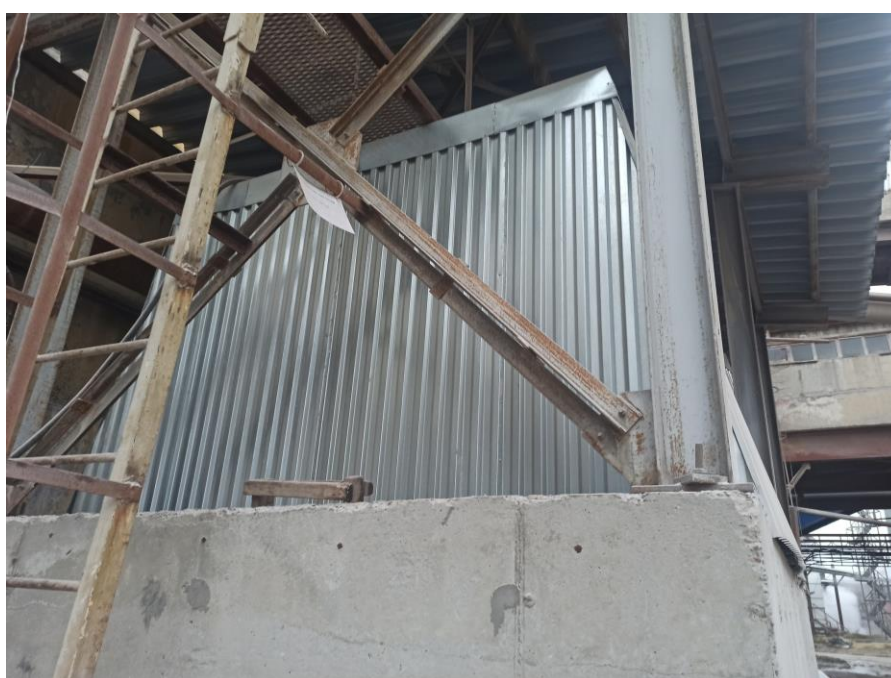
Рис. 3. Следы коррозии металлических конструкций арматуры
