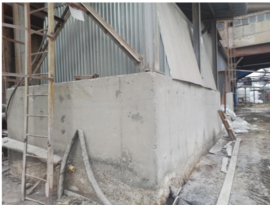
Рис. 4. Общее состояние конструкций резервуара
