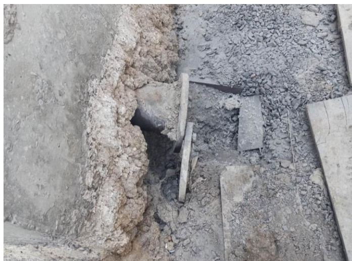
Рис. 2. Неисправный вентиль запорной арматуры
