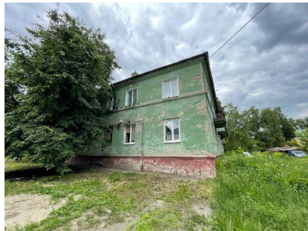
Рис. 3. Фотография существующего аварийного жилья (вид сбоку)
