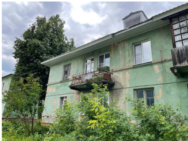
Рис. 2. Фотография существующего аварийного жилья
