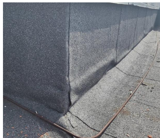
Рис. 2. Некачественное примыкание рулонного ковра к вертикальной поверхности парапета
