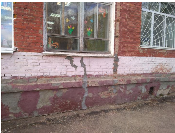
Рис. 4. Трещины на фасаде здания и разрушения штукатурного слоя
