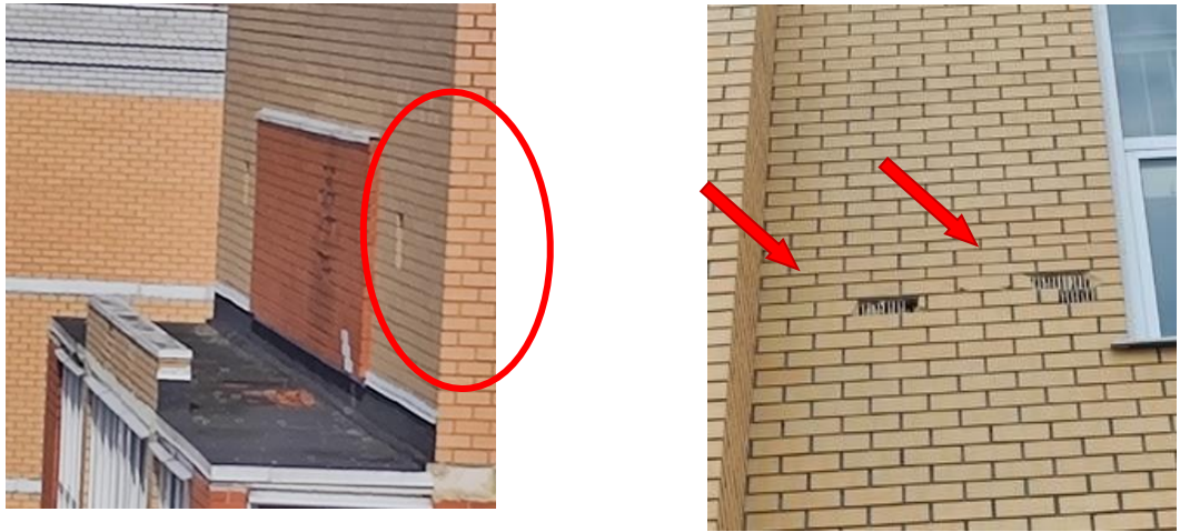
Рис. 3. Разрушение кирпичной кладки
