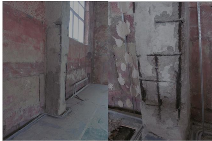
Рис. 2. Разрушение защитного слоя бетона колонны и коррозия арматурных рабочих стержней
