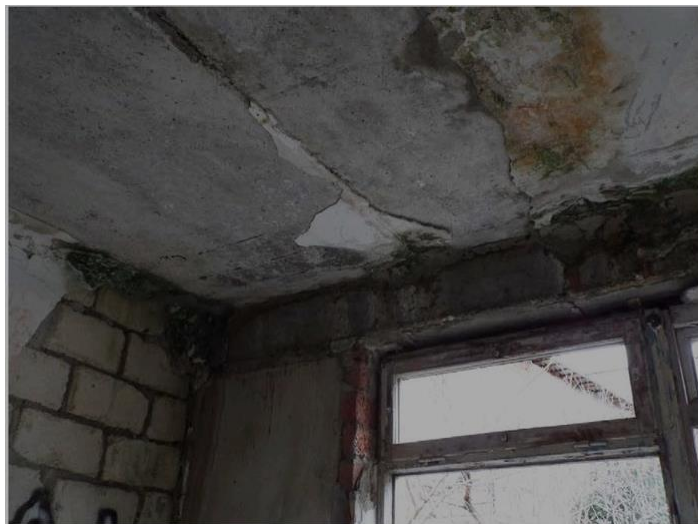
Рис. 3. Трещины в многопустотных конструкциях перекрытия, коррозия стержней и арматурных изделий
