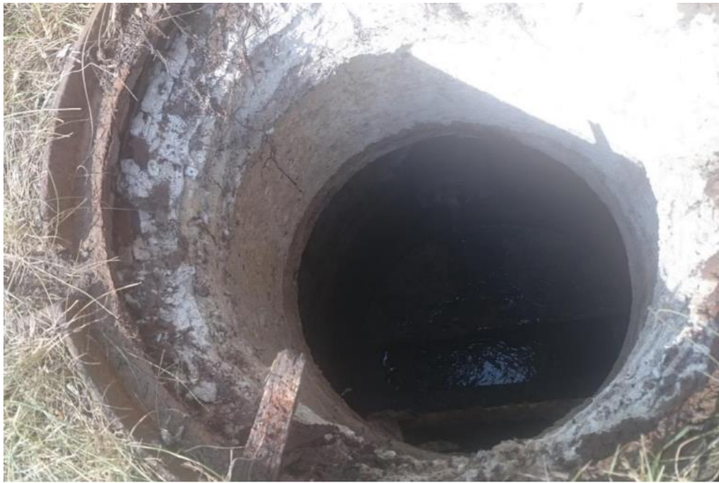
Рис. 1. Состояние канализационного колодца
