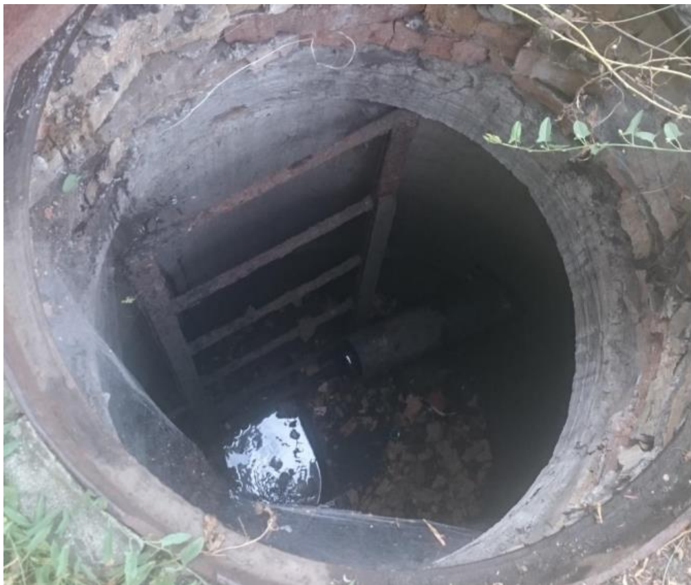
Рис. 2. Состояние канализационного колодца
