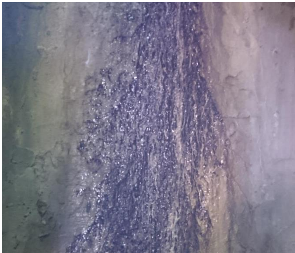
Рис. 3. Плесень на стене насосной станции
