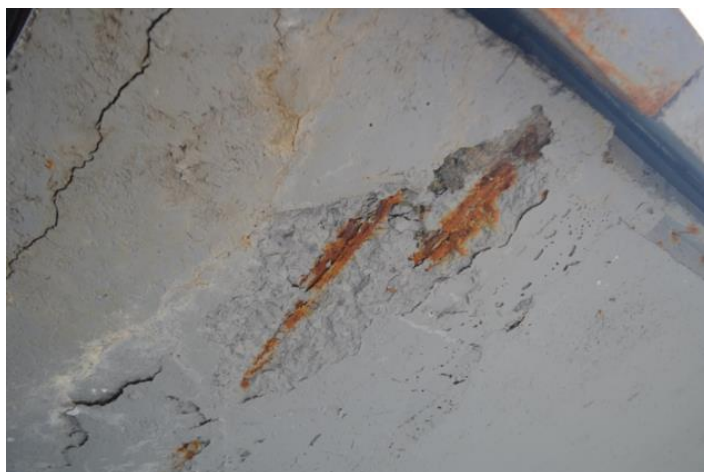
Рис. 1. Разрушение защитного слоя и коррозия арматуры плиты сталежелезобетонного пролетного строения моста [3]
