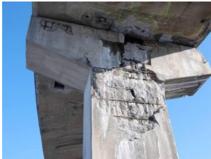
Рис. 4. Разрушение защитного слоя и коррозия арматуры ригеля и тела опоры моста
