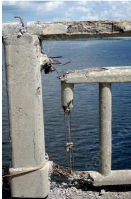
Рис. 3. Разрушение конструкции перильного ограждения моста [4]
