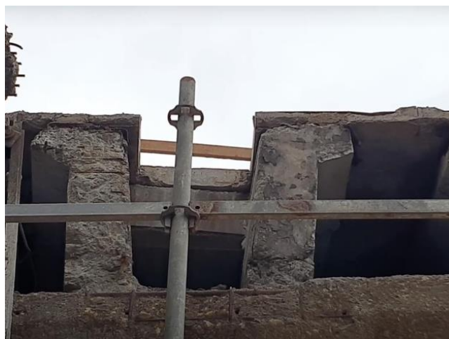
Рис. 2. Разрушение защитного слоя и коррозия арматуры балок путепровода [1]
