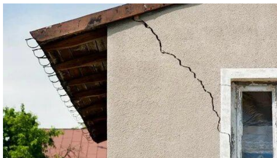
Трещина на фасаде дома по ул. Новоселов, 115
