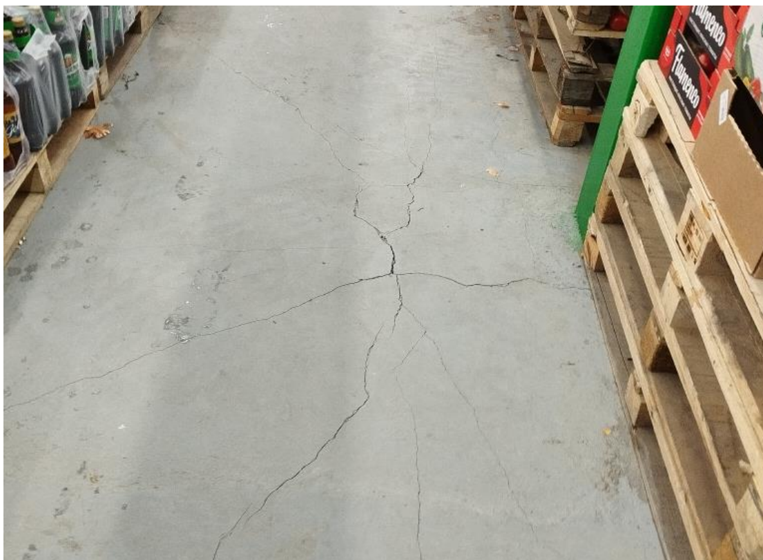
Рис. 1. Трещины плиты покрытия
