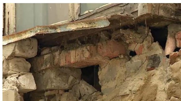
Обрушение стены общежития по ул. Тамбовской, 20 в результате её намокания из-за внутренних утечек в канализации
