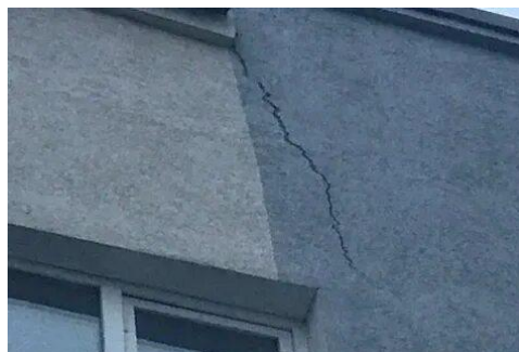
Трещина на стене дома по ул. Сузюмова, 6
