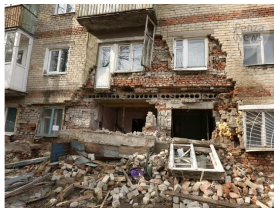
Обрушение стены в доме по ул. Ударной, 38
