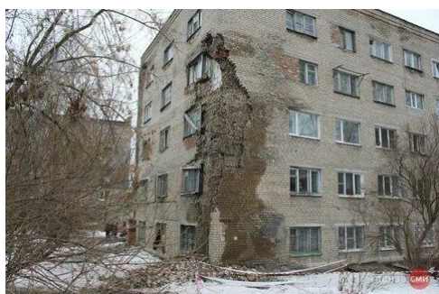
Разрушение кирпичной кладки стены водой, которая при таянии снега и во время дождя попадала внутрь дома через крышу (ул. Кулибина, 10)
