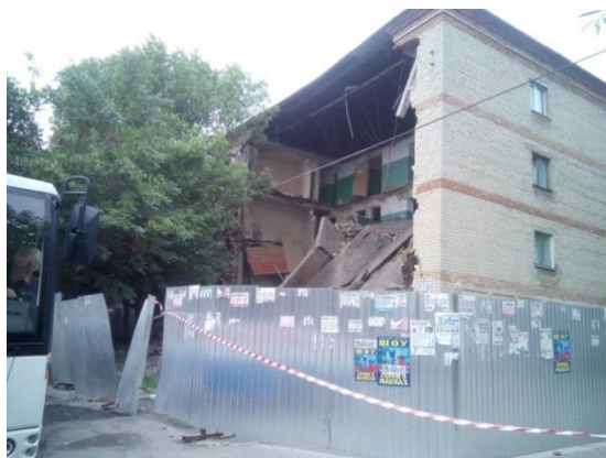
Обрушение перекрытий в доме по ул. Ударной, 35
