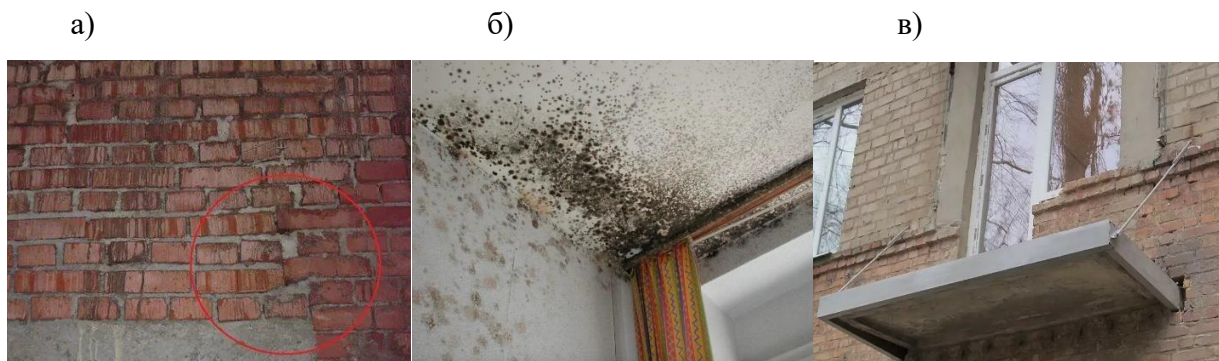
Рис. 2. Дефекты кирпичных стен: а) - прогибы, провисание, выпучивание отдельных участков кирпичной кладки; б) - замачивание конструкций наружных и внутренних стен, приводящее к образованию плесени и грибков; в) - образование трещин в местах устройства оконных проемов, заделки балконных плит и других конструктивных элементов.
