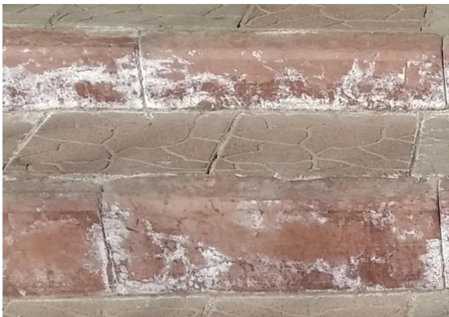
Рис. 1. Образование высолов на поверхности объемно окрашенных бетонных ступеней
